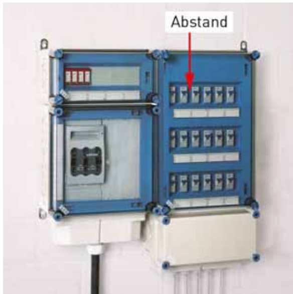
Bild 16: Verteiler für PV-Anlage (Quelle Hensel)
