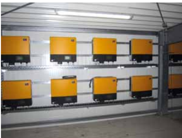
Bild 9: Wechselrichter auf nichtbrennbaren Untergrund
