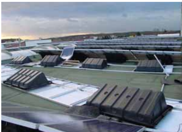
Bild 8: Sturmschaden durch Nichtbeachtung der Systemstatik (Quelle Mannheimer)
