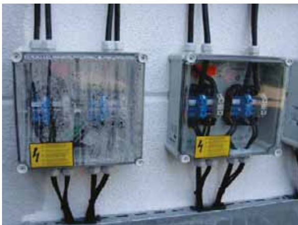
Bild 17: Kondenswasserbildung im Generatoranschlusskasten (Quelle Markus Scholand)
