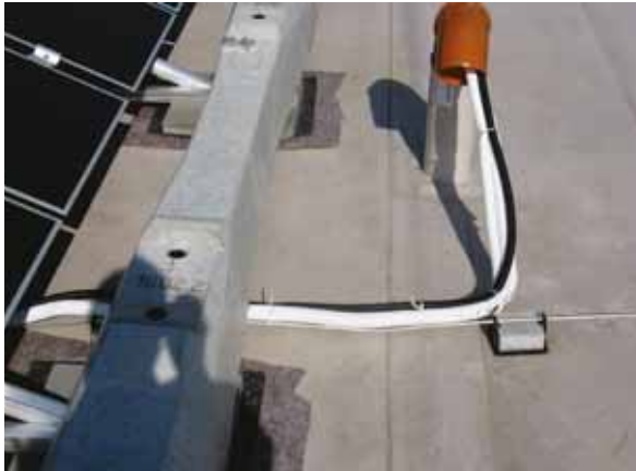
Bild 18: Abstand zwischen DC-Leitungen und Blitzschutzanlage nicht eingehalten (Trennungsabstand) (Quelle Markus Scholand)
